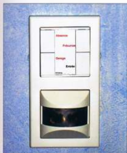
Avec 10 zones prévues, les lumières des halls et escaliers sont pilotées par des détecteurs de mouvements.
