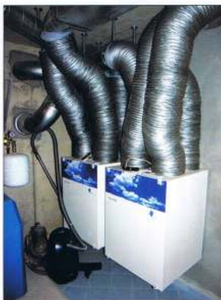
Ventilation double flux reliée à un puits canadien.
