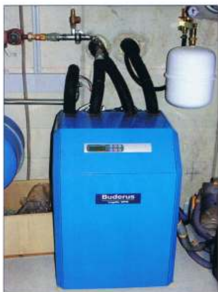
Chauffage pompe à chaleur sol/eau combiné au solaire thermique.
