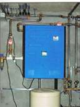
Adoucisseur d'eau, traitement eau potable par osmose inverse.
