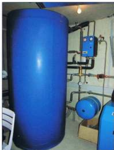
Boiler de 600 litres relié aux capteurs solaires.
