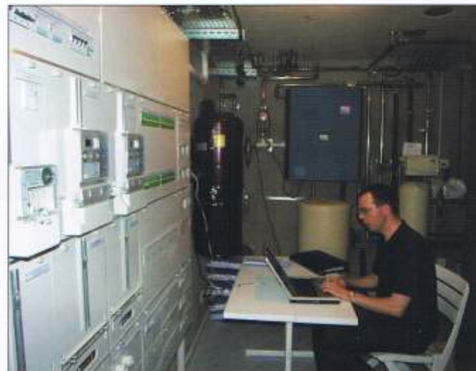
Dominique Frossard, un des rares domoticiens en activité en Suisse romande, règle sur son ordinateur les paramètres informatiques de l'installation – pièce par pièce – selon les désirs des utilisateurs.
